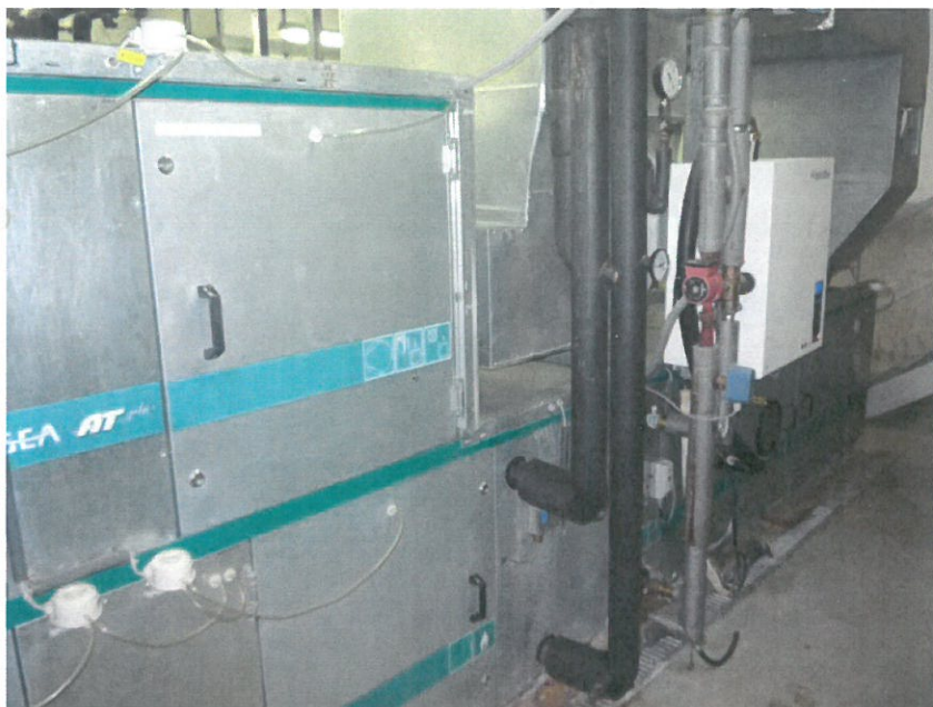
Pohled na VZT 15A a na sestavu s VZT 15
