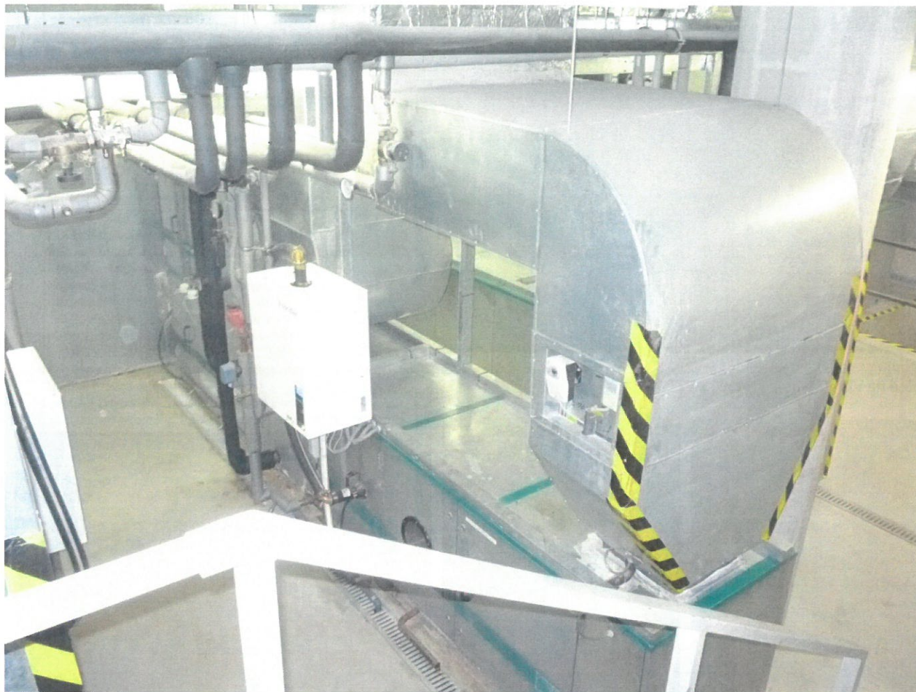
Celkový pohled na stávající VZT zařízení VZT 15, VZT 15A
