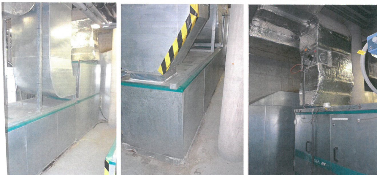
Pohled na zadní část VZT jednotky a odstup od nosného sloupu, napojení potrubí VZT
