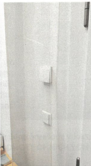
Termostat nadřazeného systémů řídící chod VZT zařízení na přívod a úpravu čerstvého vzduchu .
