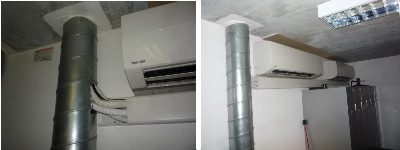
Potrubí chladiva a komunikační kabeláž přichází do 6.NP v kovové chrániče. Vpravo pohled na stávající vnitřní nástěnné jednotky.
