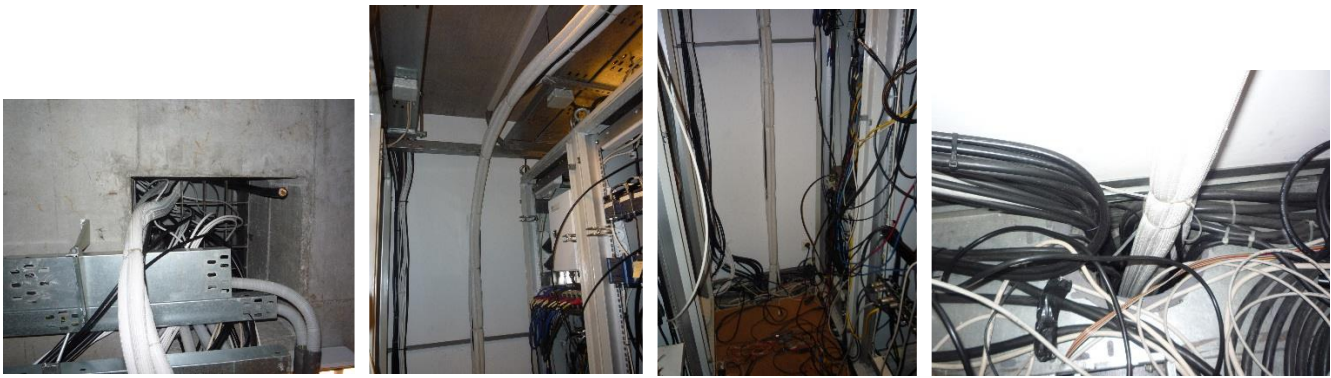
Pohled na trasu potrubí chladiva a komunikační kabeláže ze střechy směrem k vnitřním jednotkám v 6. NP. Mezi podlahou v 8.NP a stropem v 6.NP tj. cca 5 metrů je rozvod veden v kovové chrániče spolu s další kabeláží.
